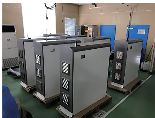
図4 電力融通のためのデジタルグリッドルータ
