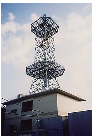
図6 山上無線中継所と鉄塔
