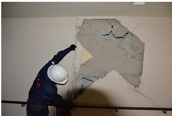
写真3 県庁行政棟本館の被災状況
