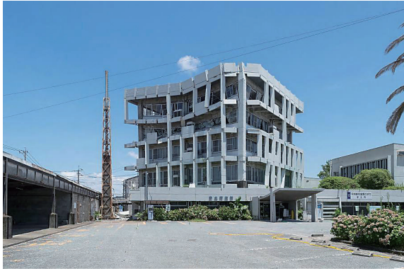
写真2 宇土市役所庁舎被災状況
