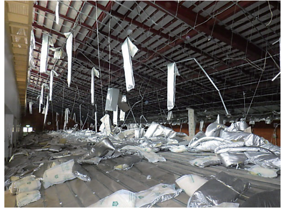
写真4 熊本総合射撃場（益城町）の被災状況
