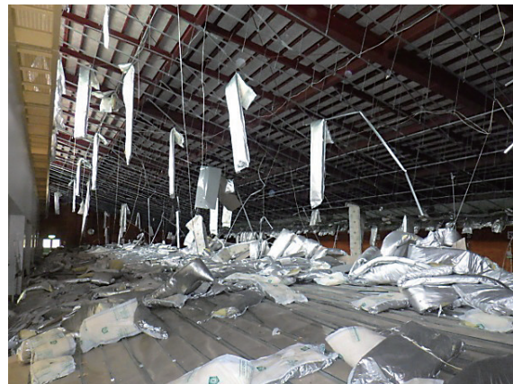
写真4 熊本総合射撃場（益城町）の被災状況
