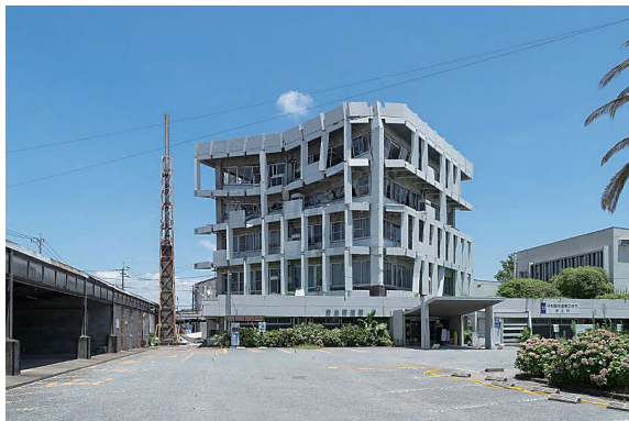
写真2 宇土市役所庁舎被災状況
