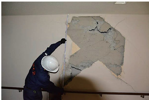
写真3 県庁行政棟本館の被災状況
